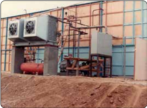
Equipos del tunel de secado.
